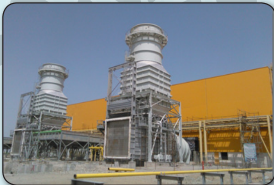
نمایی از اگزوز واحد یک و دو نیروگاه سیکل ترکیبی کهنوج
