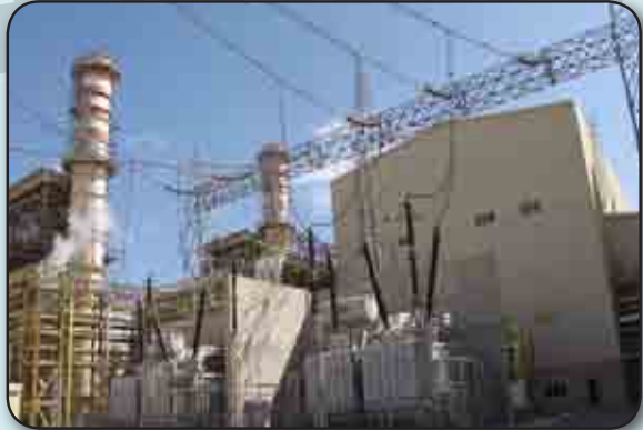
نمایی از نیروگاه سیکل ترکیبی آبادان
