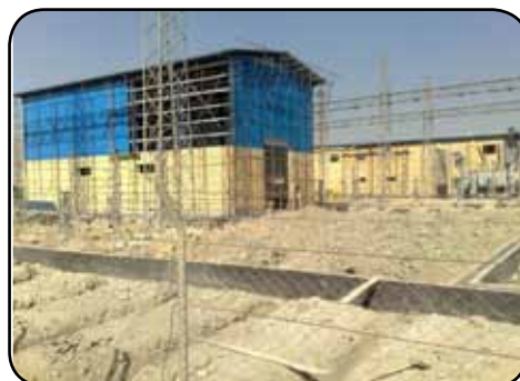
پروژه پست ابرکوه یزد
