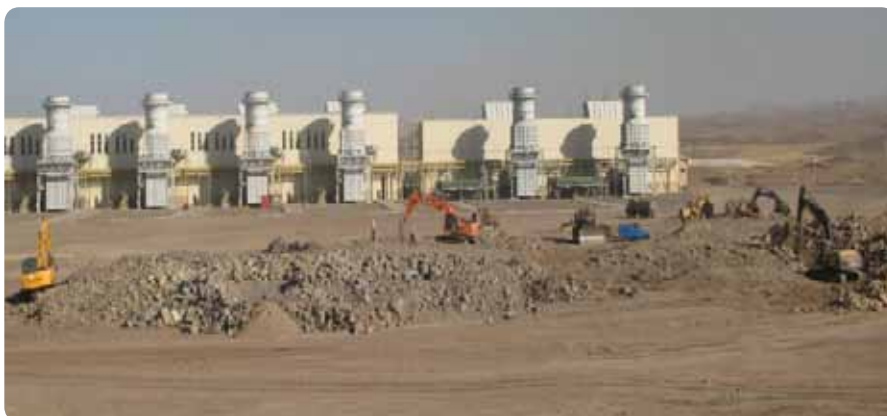
شکل ۱- نمایی از واحدهای گازی نیروگاه سیکل ترکیبی سبلان
