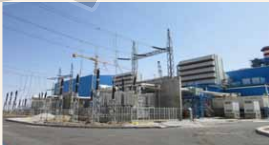
نمایی از نیروگاه سیکل ترکیبی چادرمو
