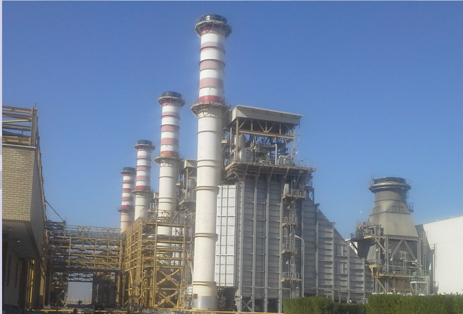
نمایی از نیروگاه سیکل ترکیبی آبادان
