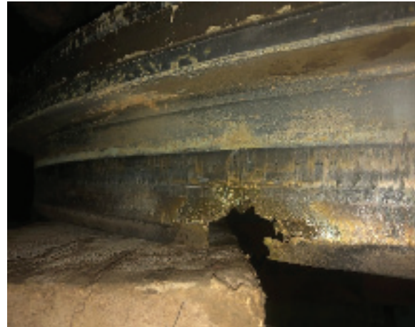
تصویر شماره ۱: آب بند شیر کروی آسیب دیده
